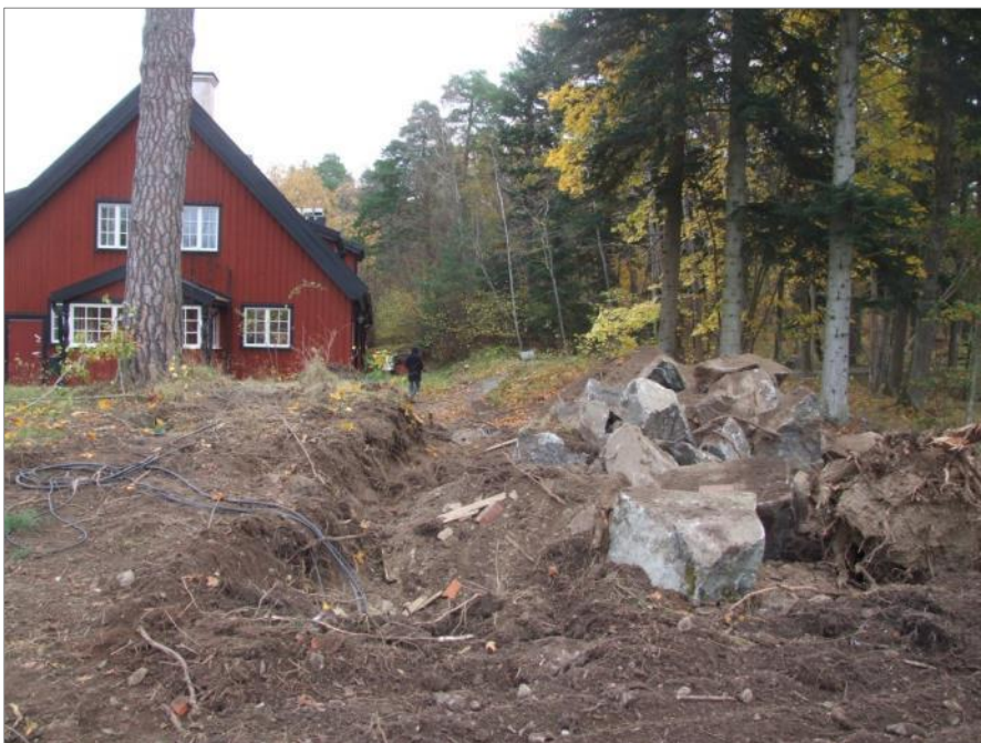
Figur 19. Norra delen av schakt 1 vid Tengbomhusets södra gavel. Stora stenblock fanns på och under markytan. Foto mot V.
