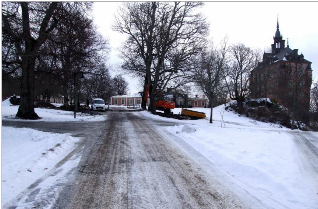
Figur 53. I sträng kyla i januari 2015 grävdes schakt för spillvatten över infartsvägen till Vik. Foto mot S.
