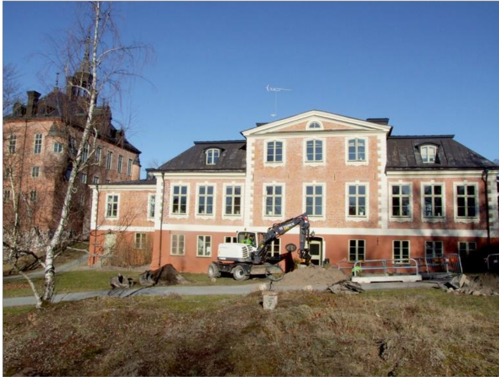
Figur 68. Grävning för dagvatten på Stenhusets södra sida, schakt 10, i mars 2015. Foto mot N.
