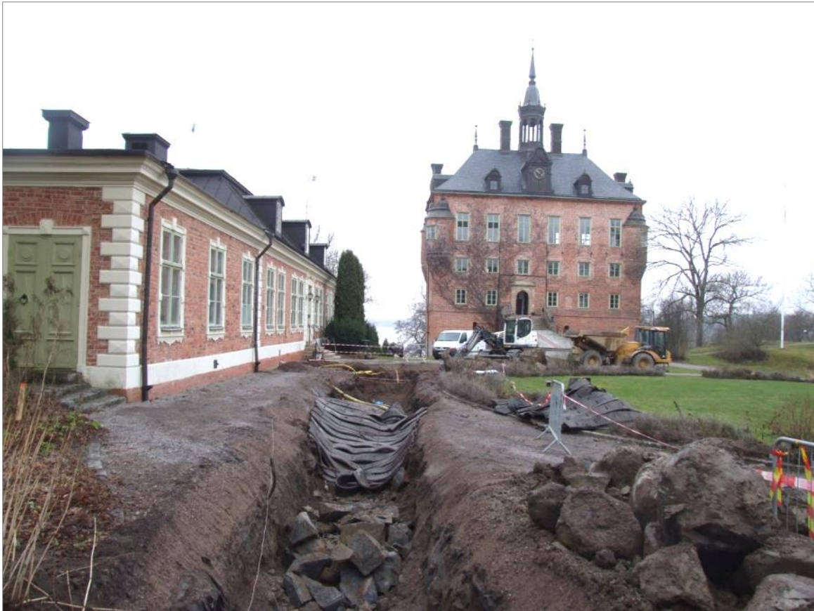
Figur 51. Schakt 6 i det närmaste färdiggrävt. I botten av schaktet finns sprängmattor. Foto mot V.
