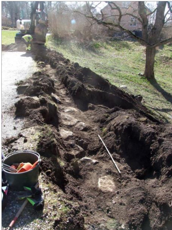
Figur 66. Kantskoning till gångväg mellan Slottet och Stenhuset. Foto mot S.
