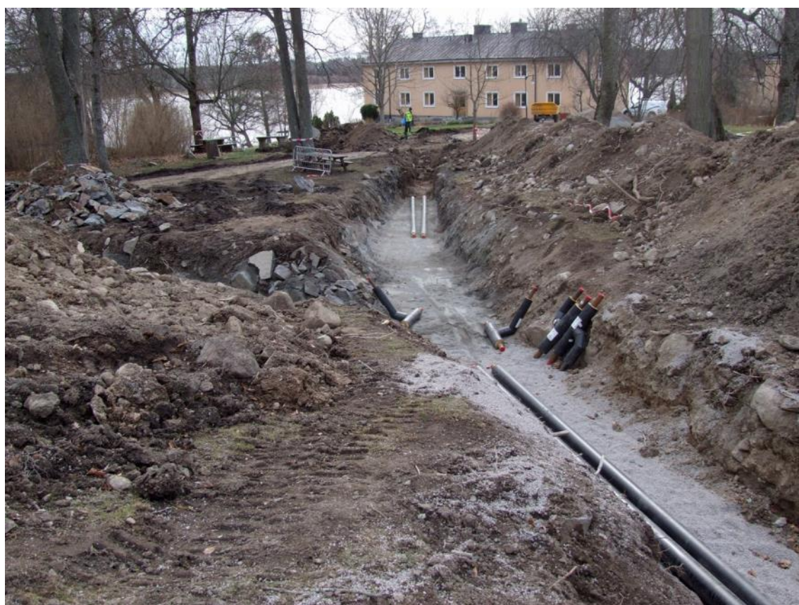
Figur 14. Värmeledningsschakt i parken söder om Stenhuset. I bakgrunden ses vattnet och Hotel And. Foto mot SV.
