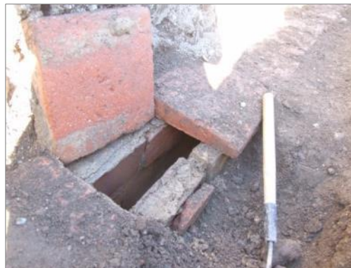
Figur 76, t.v. En takplatta i värmekanal bröts upp för att se djup och konstruktion. Foto mot V.
