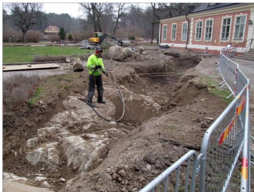
Figur 50. Det naturliga berget före sprängning. Observera att mur A7 är bortgrävd. Foto mot Ö.
