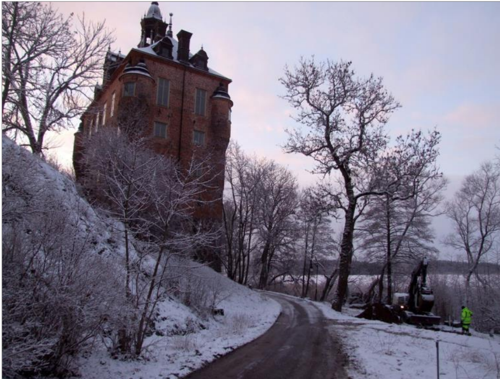
Figur 58. Tidig morgon på Vik i februari 2015. Vid körvägen nedanför, nordväst om Slottet grävs en grop för pumpstation. Foto mot S.
