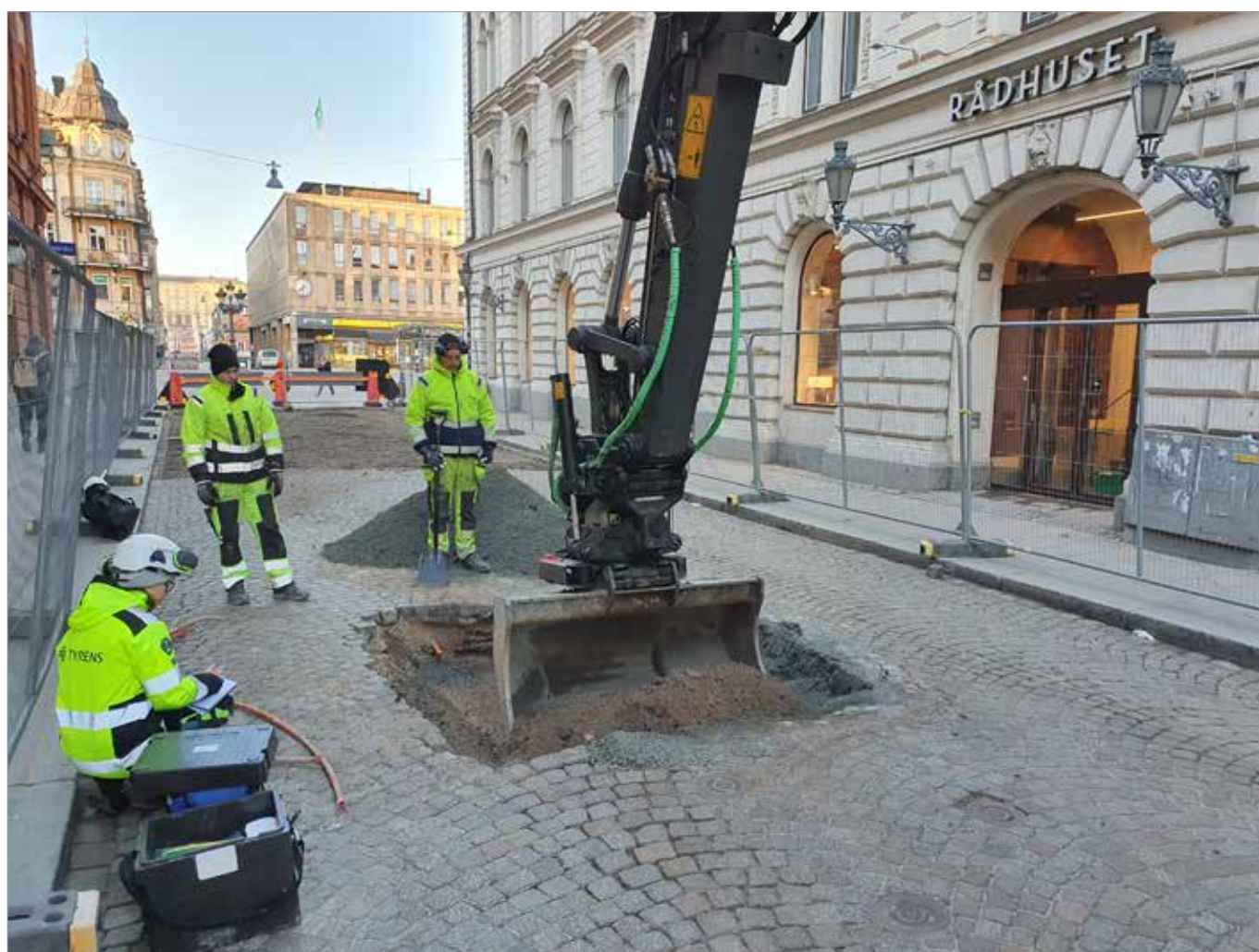
Figur 7. Schaktningsarbetet inleddes med att fyra provgropar togs upp för att möjliggöra provtagning för markkemi-analys. Foto mot SV, Joakim Kjellberg.
