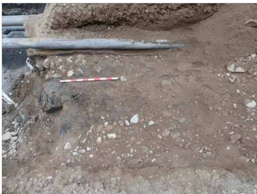
Figur 41. Dräneringsrännan B:2 löpte tätt intill en äldre ledning. I förgrunden syns den möjliga stenläggningen B:6. Foto mot NV, Joakim Kjellberg.
