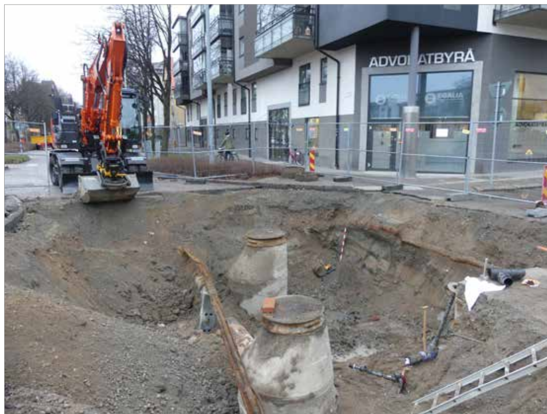
Figur 6. Foto av schakt 2 i korsningen Ringgatan – Torggatan. De dokumenterade kulturlagren i sektion 1 syns i schaktet bortre och nordvästra hörn. I förgrunden syns de brunnar som ska bytas ut och till höger en betongkammare och omfattande störningar.
