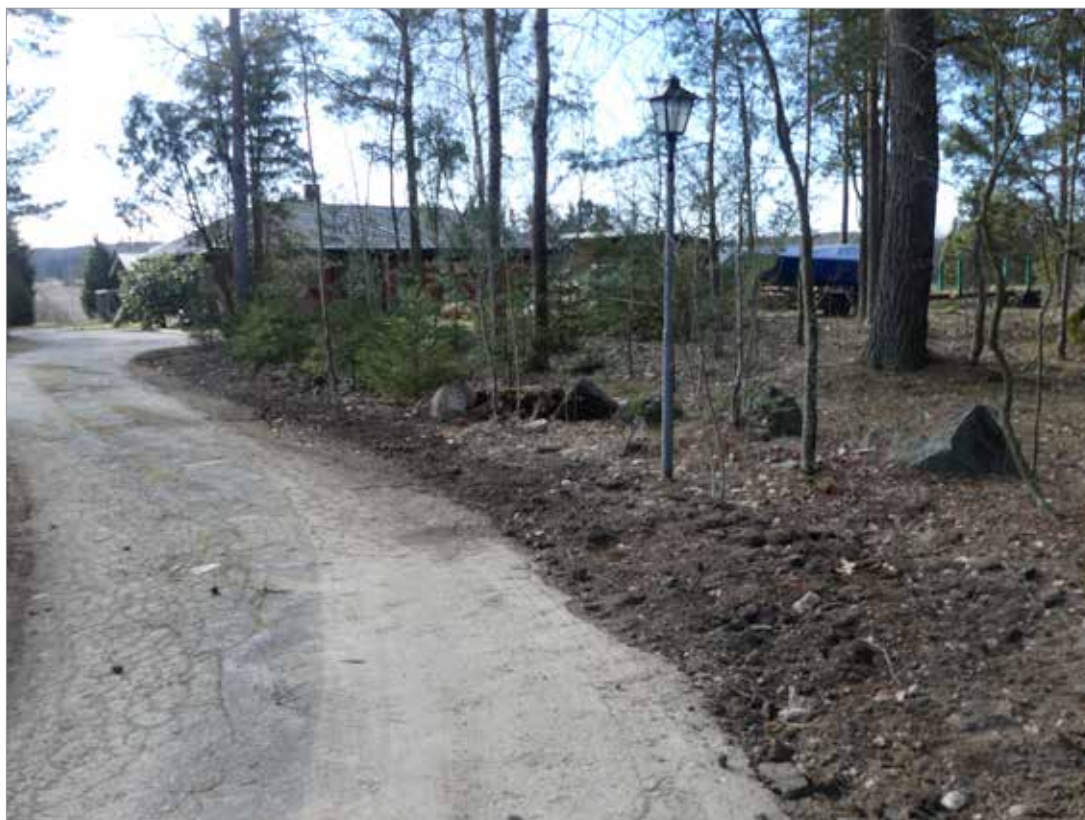
Figur 11. Igenfyllt schakt i västra kanten av infartsväg inom delområde E. Foto mot söder.
