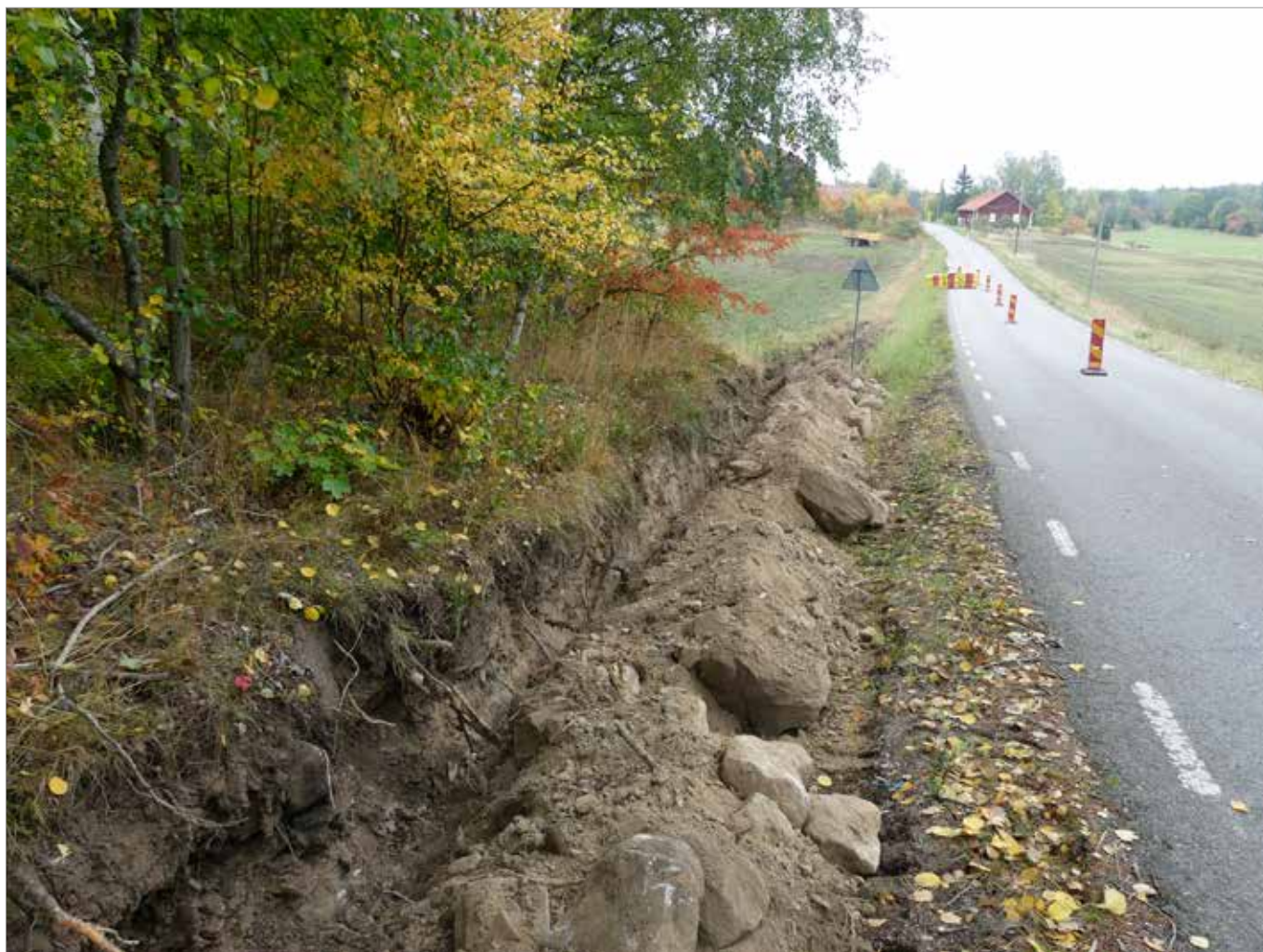
Figur 6. Schaktet grävdes i bakslänten av dike längs med väg. Foto mot söder.
