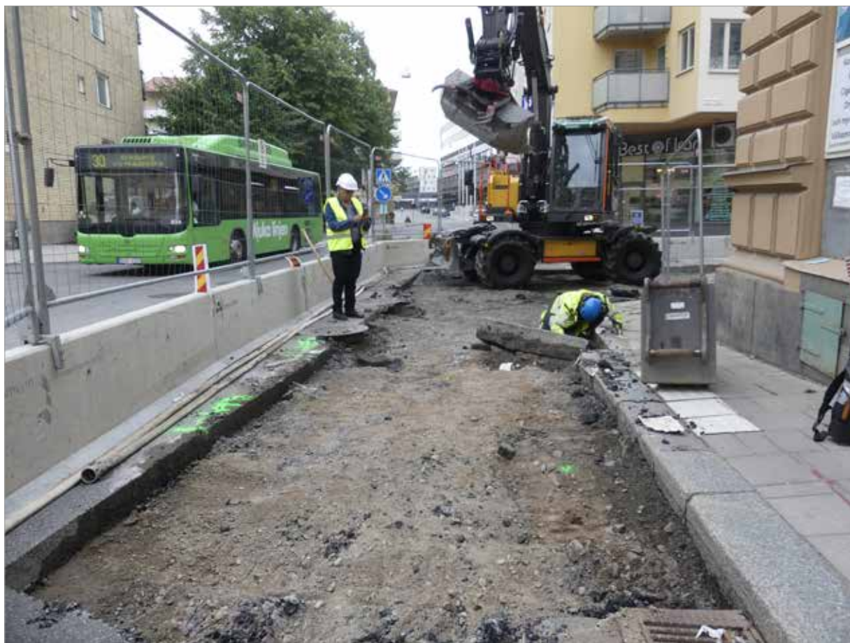
Figur 5. Avspärrning för schaktning i korsningen Bäverns gränd-Dragarbrunnsgatan. Foto mot V, Malin Lucas.
