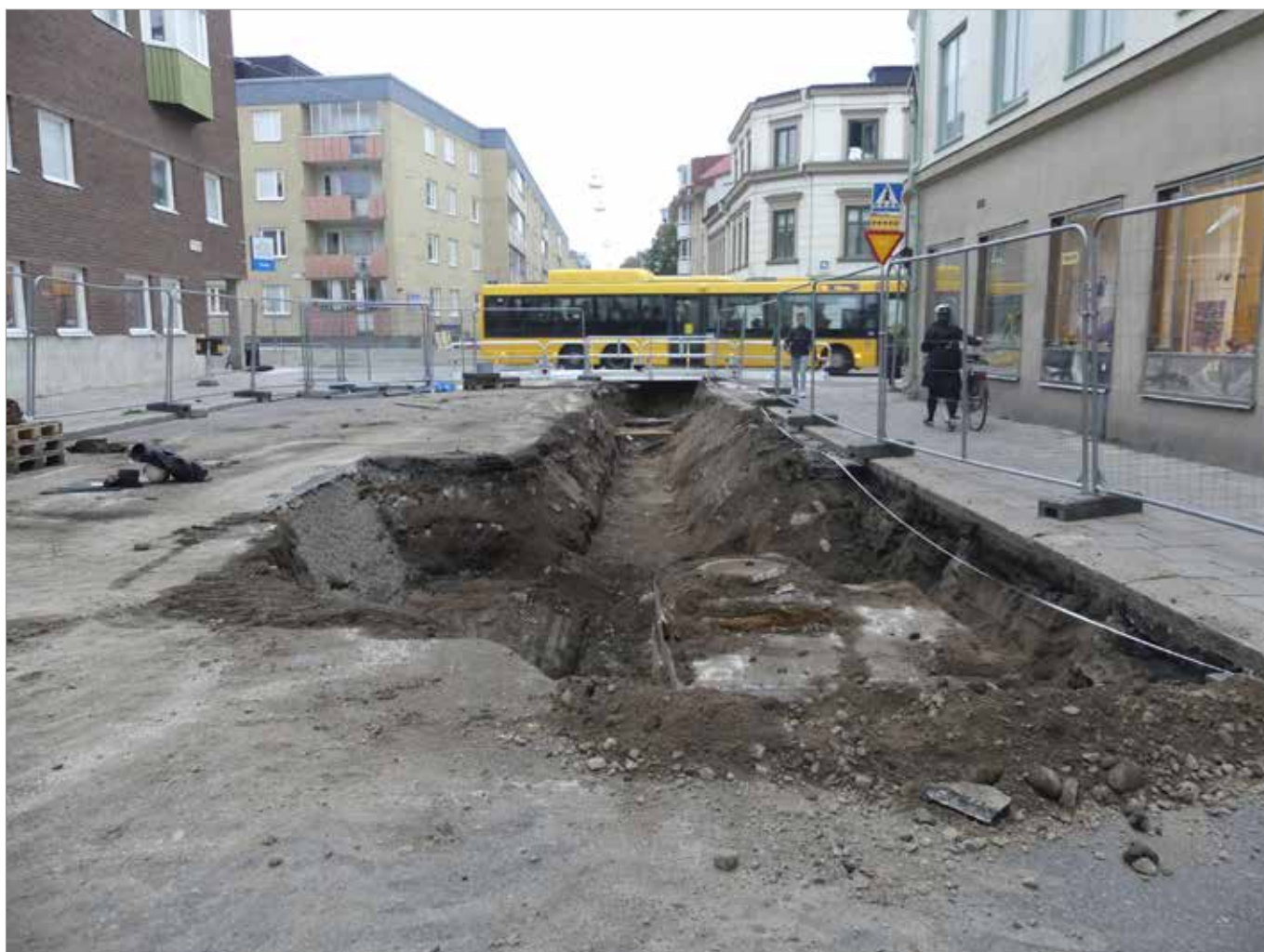
Figur 38. Schakt 6. Till väster i bild syns utvidgningen och till höger kammare till fjärrvärmens. Foto mot S, Malin Lucas.
