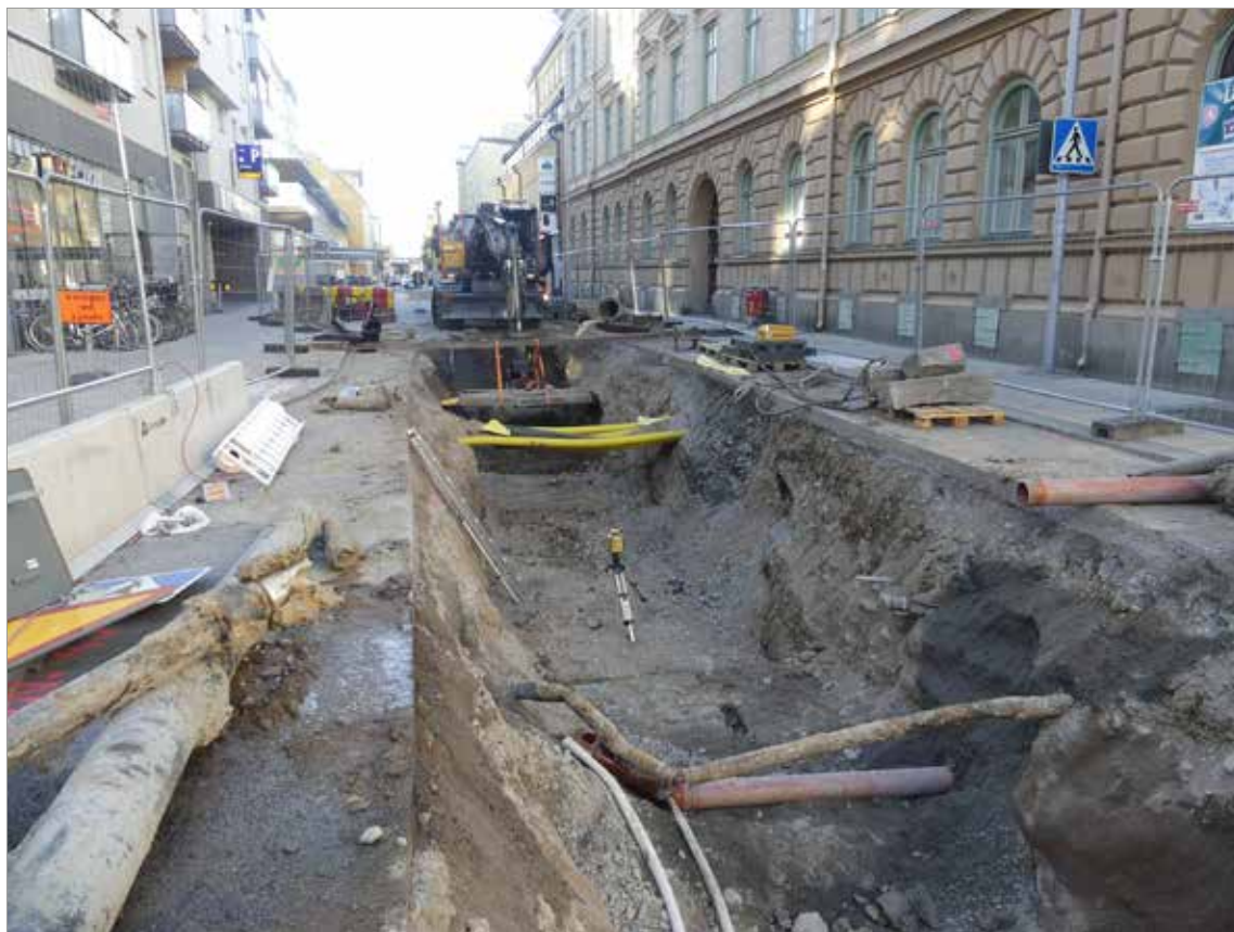
Figur 8. Schakt 1, Dragarbrunnsgatan med en del av alla ledningar och rör som fanns i schaktet. Foto mot S.O., Malin Lucas.
