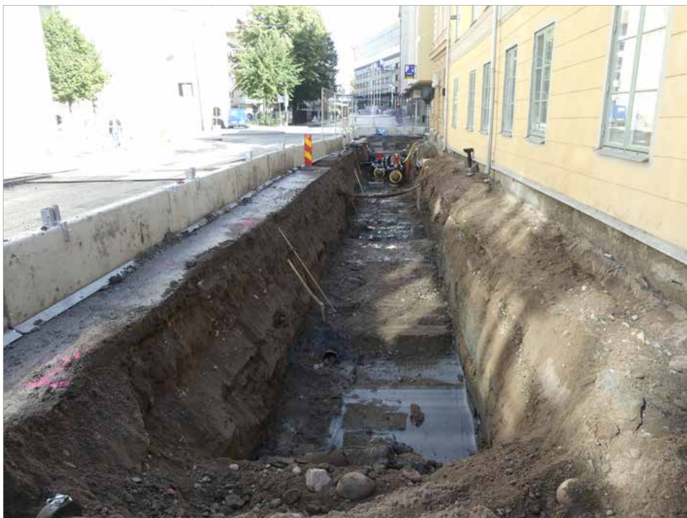
Figur 11. Den östra delen av schakt 1 i Bäverns gränd. Längst bort i schaktet har den nya fjärrvärmens redan börjat läggas. Foto mot NO., Malin Lucas
