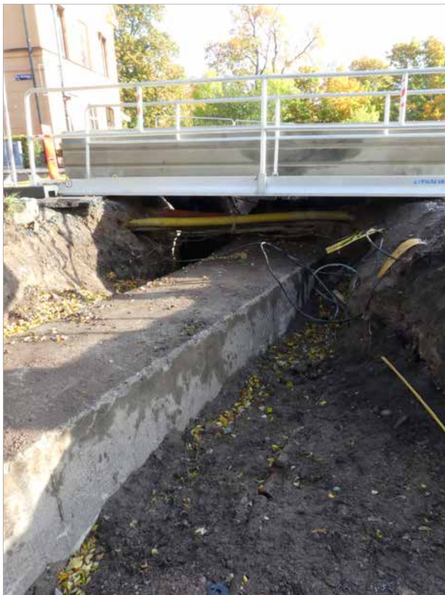
Figur 58. Schakt E genomkorsades av den kulvert som också korsat schakt A, B, D och F. I schaktet fanns också flera ledningar. Foto mot NÖ.
