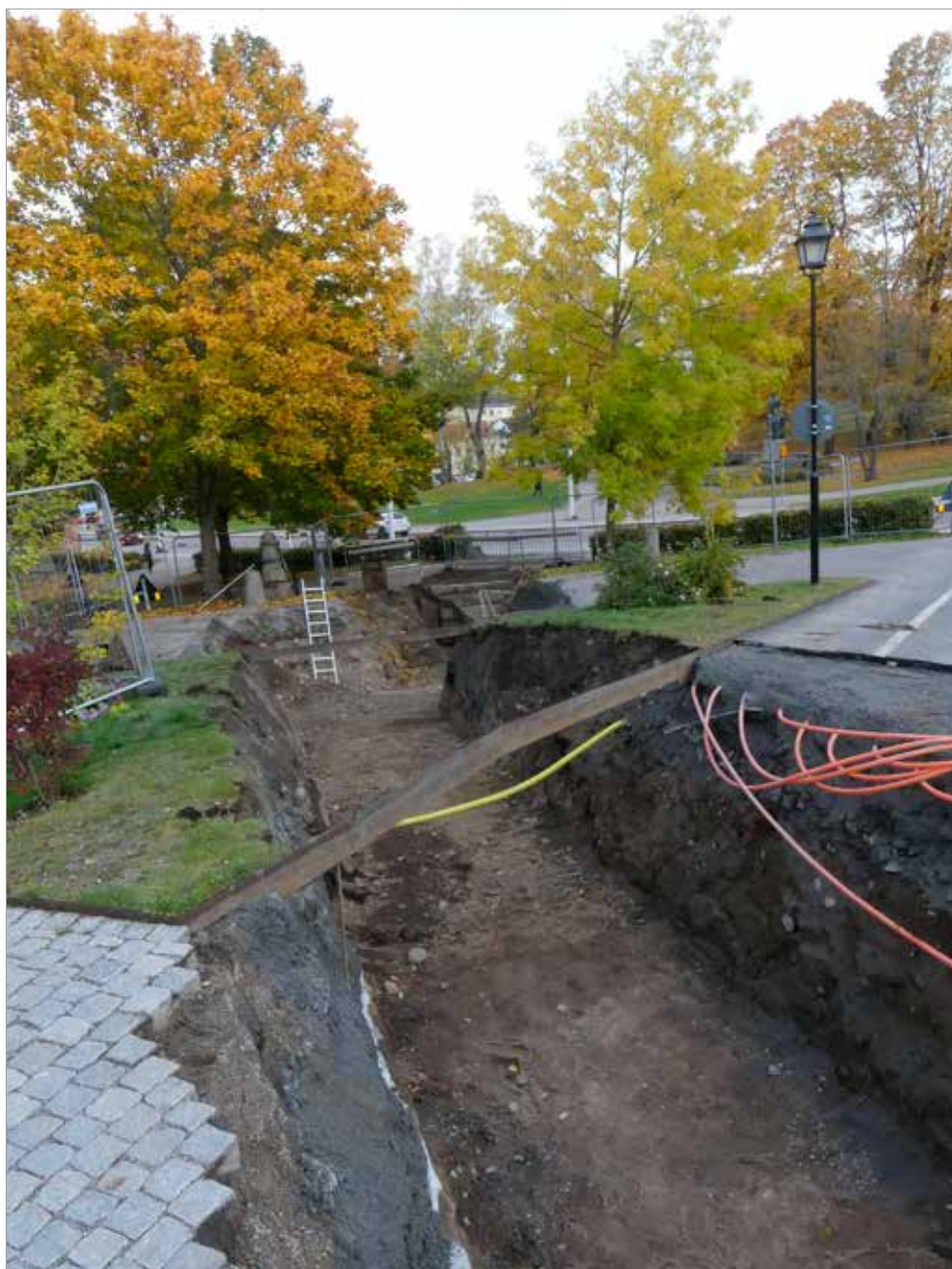
Figur 61. Schakt F grävdes från Övre Slottsgatan och genom Odinslund mot Carolinabacken. Området sluttade ned mot Carolinabacken/Drottninggatan och schaktet var till stor del var uppfyllt av recenta massor. Foto mot Ö.
