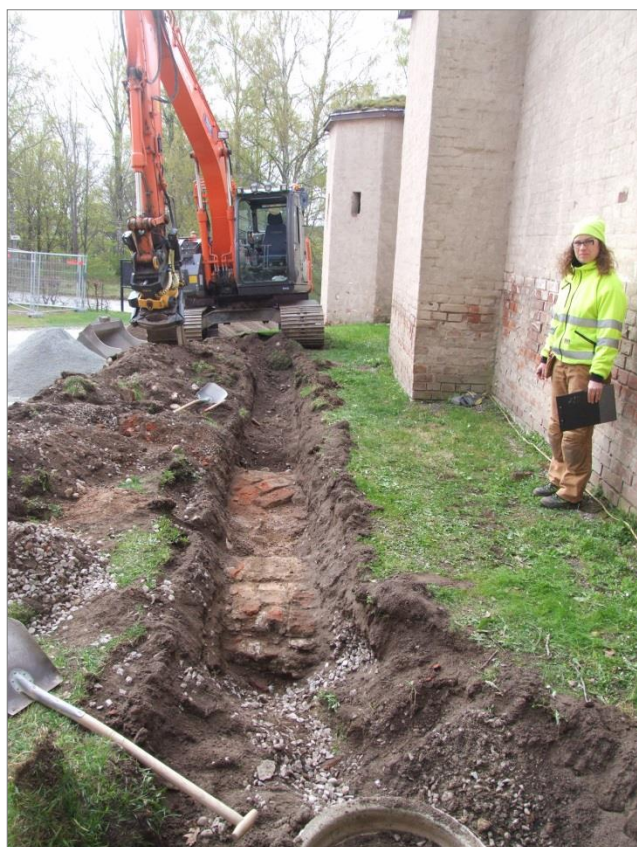
Figur 7. Schaktet längs Gräsgårdens flank vid 2015 års schaktningsövervakning. I schaktet påträffades grundmurar till en krutkammare. Foto Anna Ölund, Upplandsmuseet.
