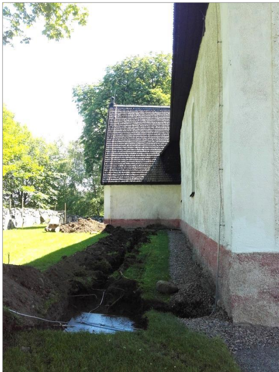
Figur 14. Schaktet längs kyrkans norra del. Väster om sakristian hade ett antal gråstenar redan grävts upp när arkeolog kom till platsen. Inget kalkbruk syntes bland stenarna eller i schaktet. Eventuellt kan stenarna ha hört till en kallmurad mur. Foto mot Ö.
