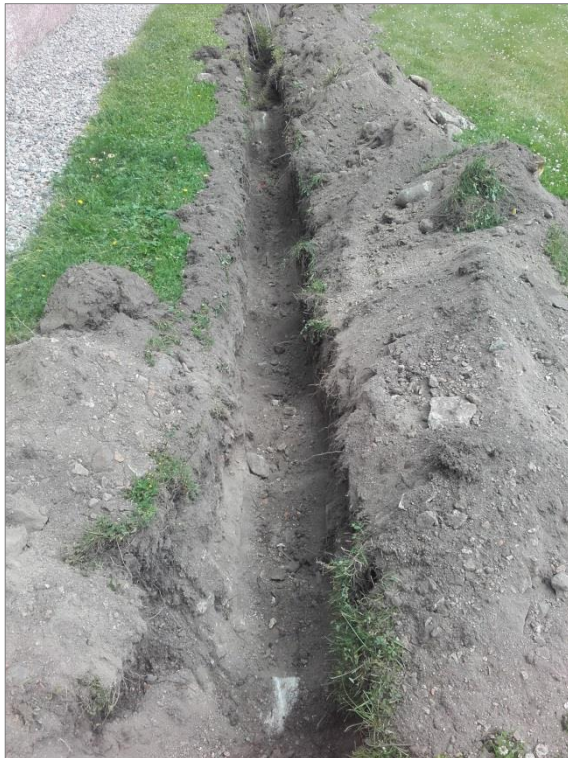
Figur 12. I schaktet längs långhusets södra sida påträffades två större stenar (C) ca 0,2 m under mark. Foto mot Ö.
