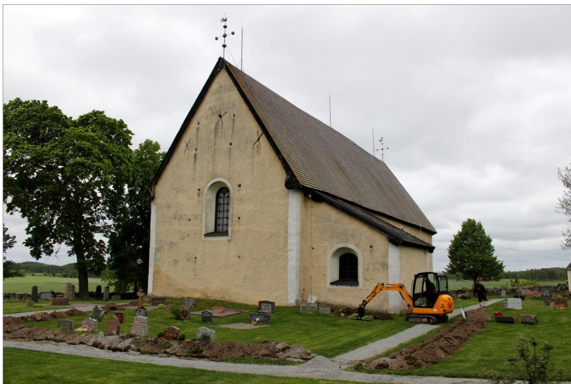
Figur 4. Pågående schaktningsarbeten vid Kungs-Husby kyrka i maj 2016. Långhuset och sakristian uppfördes under 1300-talet. Foto mot SV.
