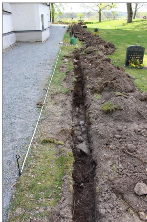
Figur 13. Översikt med stenkonstruktionen B närmast i bild och murresterna C bortanför. Foto mot V.
