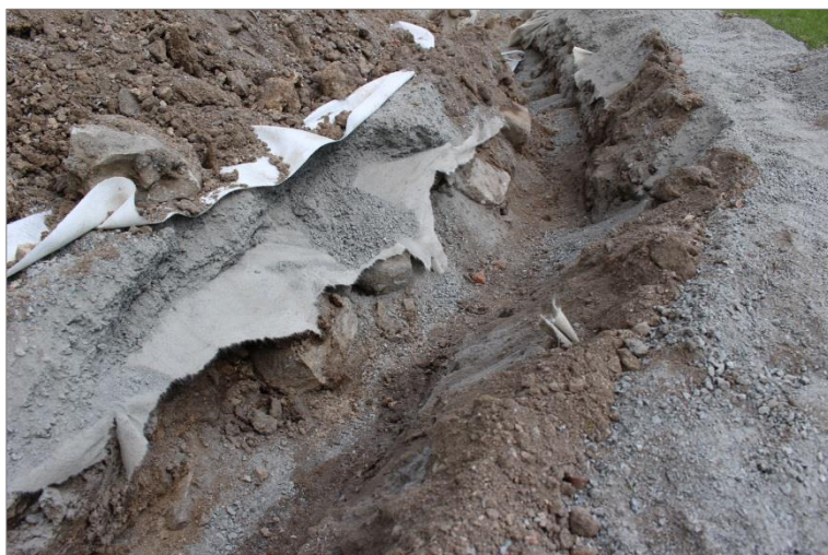
Figur 21. Stenarna H som fanns i den norra schaktkanten på kyrkans södra sida. Foto mot Ö.
