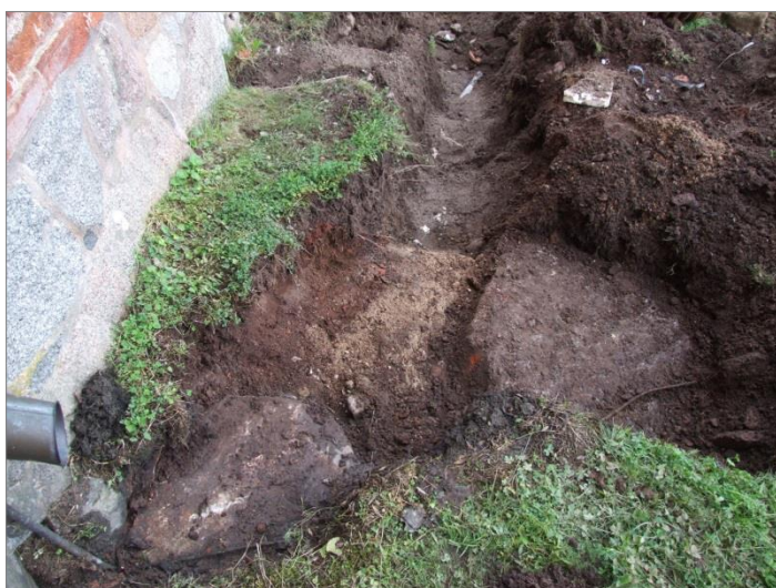
Figur 29. Stuprör mellan kor och sakristia. I schaktet ses en grundsten till koret som murats direkt på berget. Till höger sticker en bit av berghäll upp.
