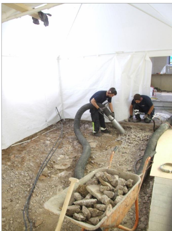
Figur 35. För att få ut det bortbilade betonggolvet liksom undersökta kulturlager användes en sugbil. Foto mot NÖ, Malin Lucas Upplandsmuseet.
