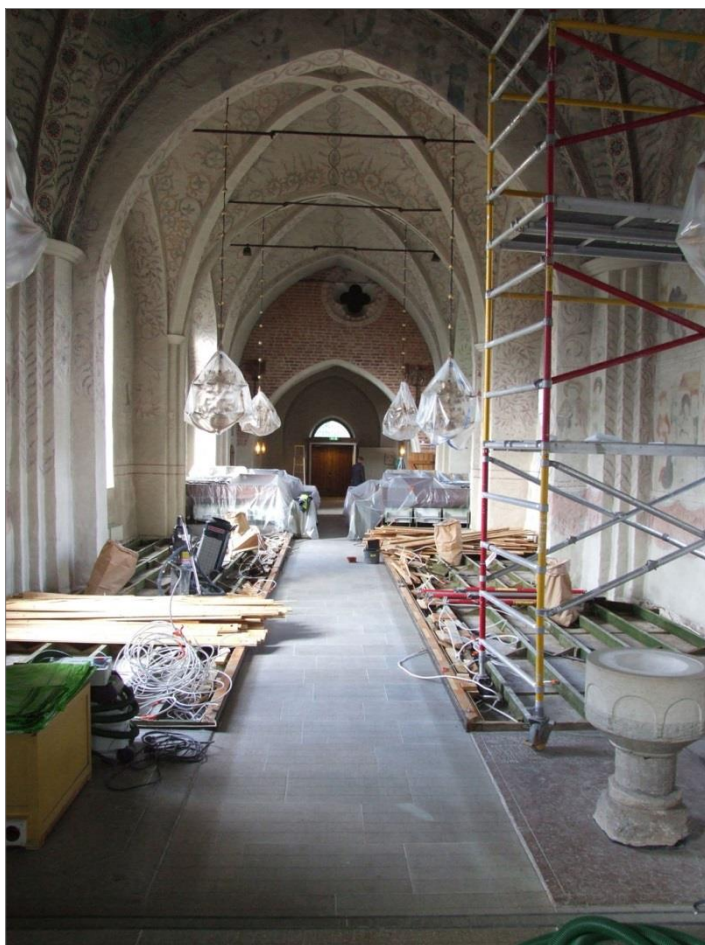
Figur 31. Danmarks kyrka när bänkar och golv lyfts ut ur kyrkan strax innan betongplattan bilades bort. Foto mot V.
