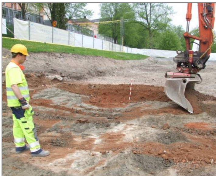
Figur 40. Vid den avslutande schaktningen skalades de sista delarna av kulturlagren bort på ytan (schakt 100). Meterstocken markerar botten på den rännformade nedgrävningen S1145 under tegelkrosslagret S215. Djupet är närmare 0,7 m från ytan av krosslagret ner till den orörda leran. Andreas övervakar. Foto mot NV. Dan Fagerlund, Upplandsmuseet.
