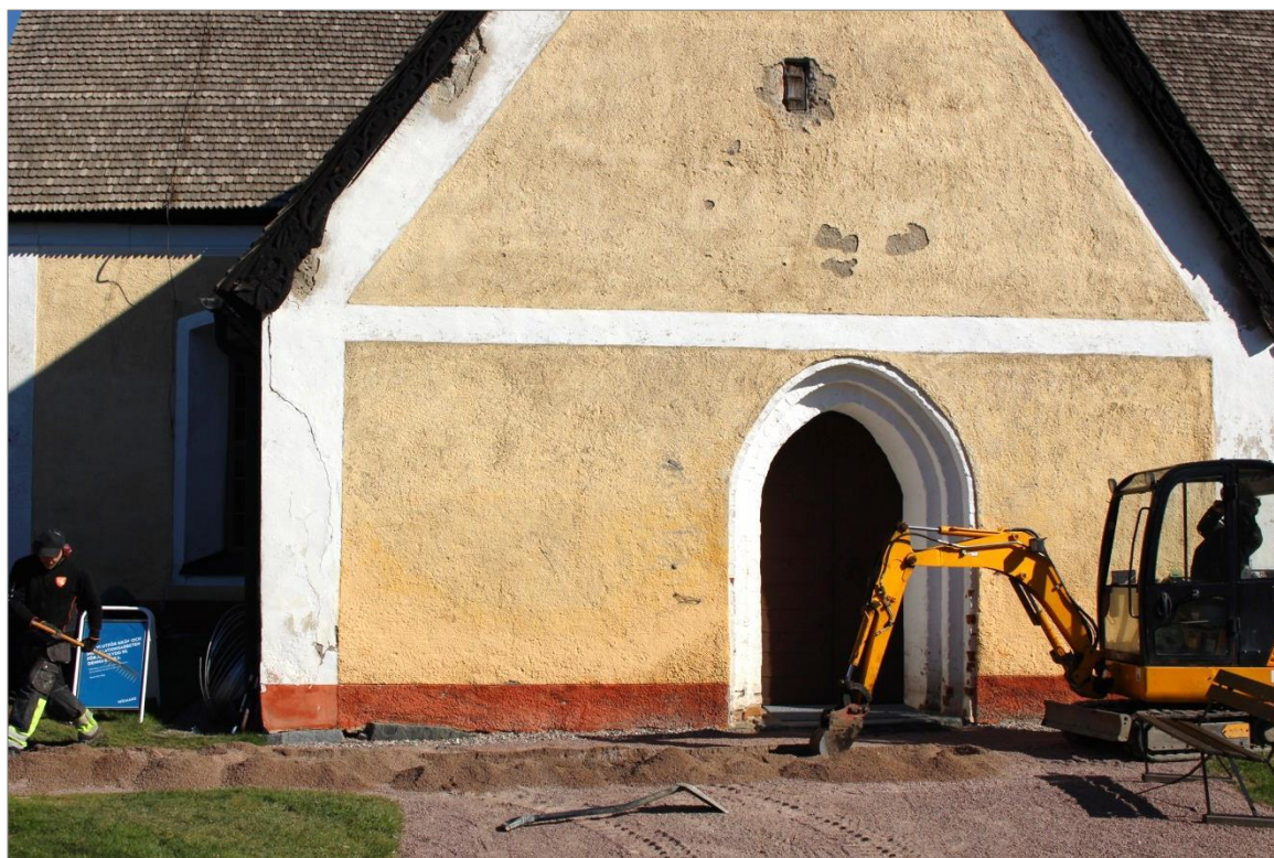
Figur 4. Pågående schaktningsarbeten längs Boglösa kyrkas vapenhus. Foto mot N. Anna Ölund, Upplandsmuseet.
