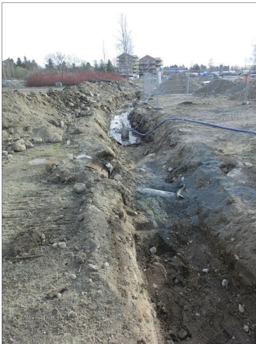
Figur 7. Foto av västra delen av schaktet inom etapp 1. Förutom att en mängd andra ledningar som korsade schaktet så var området till stor del uppfyllt av sprängsten och annan utfyllning. Foto mot öster, 2015-04-09.
