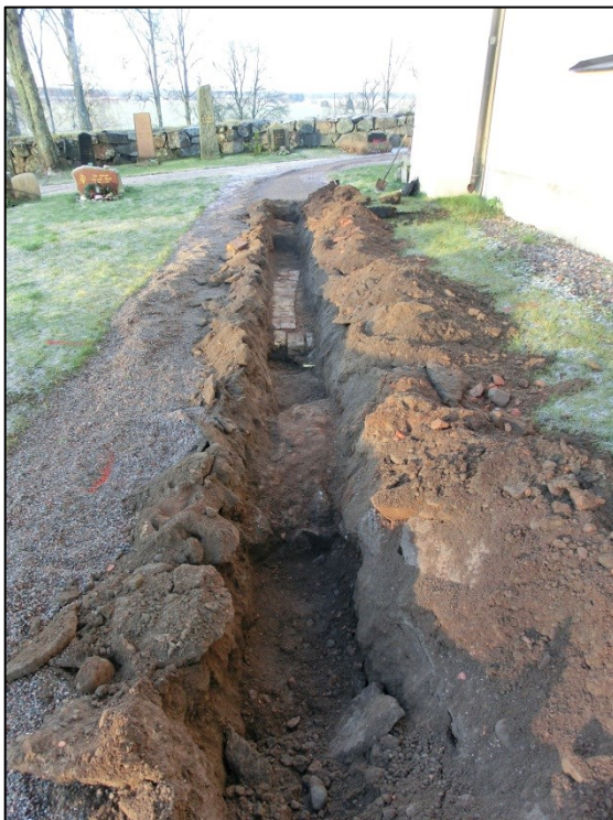
Figur 9. Schaktet med den östra grundmuren närmast i bild, därefter följer tegelraden och längst bak i bild den västra grundmuren. Foto mot väster, 2014-12-04.
