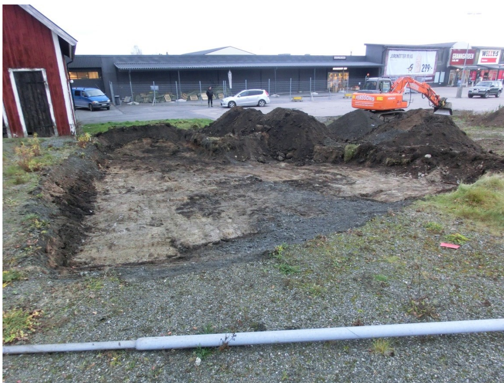
Figur 11. Undersökningsytan efter att den schaktats färdigt. I förgrunden syns resterna efter en tidigare grusad väg ner till uthuset. Foto från norr, 2014-11-18.
