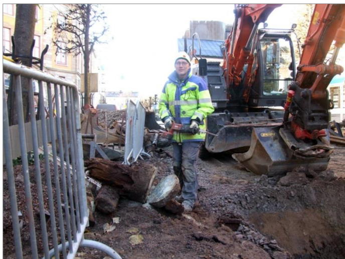
Figur 45. Dan Fagerlund i färd med att såga till skivor av påträffat konstruktionsvirke som sedan skickades på dendrokronologisk analys för datering. Foto mot V.
