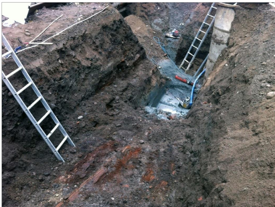
Figur 26. Östra delen av det övre lagret i kavelbro A2. Foto mot NÖ.
