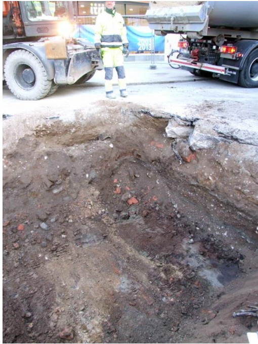
Figur 40. Raseringslagret A10 schaktas bort och det underliggande gödselbemängda lagret kommer fram. Foto mot SV.
