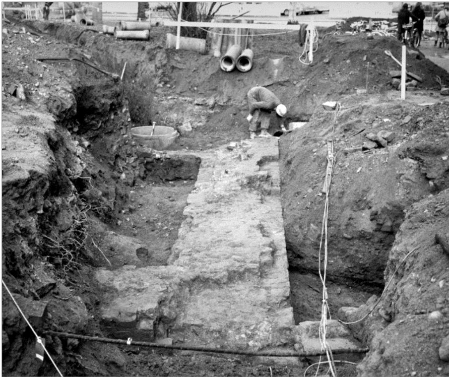
Figur 9. En arkeologisk undersökning i Universitetsparkens norra och nordöstra del företogs 1972. Bilden visar kraftiga tegel- och gråstensmurar vilka påträffades i samband med grävningar för dagvattenledning. Murresterna som låg 5,5 m väster om Historicums SV hörn, är troligen lämningarna efter det gamla Länslasarettets gårdshus (UM arkiv). I bakgrunden ses S:t Larsgatan och till höger utanför bilden finns Historicums västra fasad. Foto mot NÖ. Fotograf okänd. P1169_1, Upplandsmuseet.
