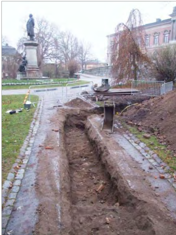
Figur 66 (t.v). Övre delen av schakt 6 vid A20. I bakgrunden ses Geijerstatyn och universitetshuset. Foto mot S.
