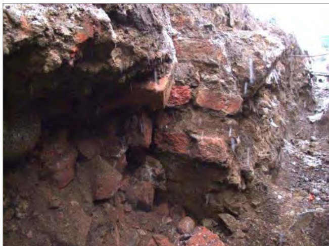
Figur 42. A7, Skadade murrester.
