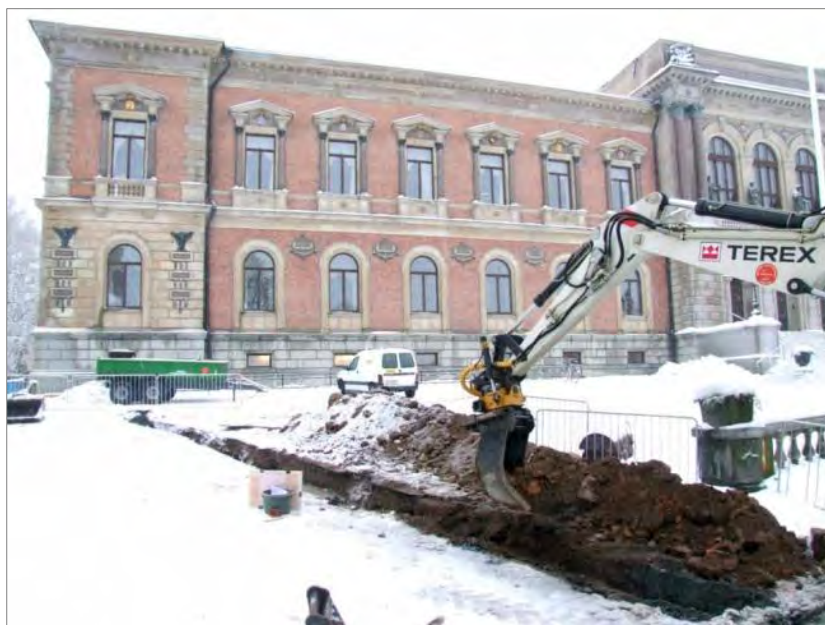
Figur 21. Schaktningsarbeten för dagvatten i ett kallt och snötäckt Uppsala. I bakgrunden universitetshusets sydöstra fasad. Foto mot V.
