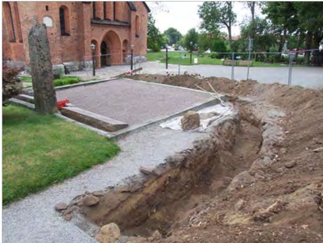
Figur 19. Översikt av schaktet etapp 2 vid svängen vid Lärarinnehemmets gravplats. Foto mot S.
