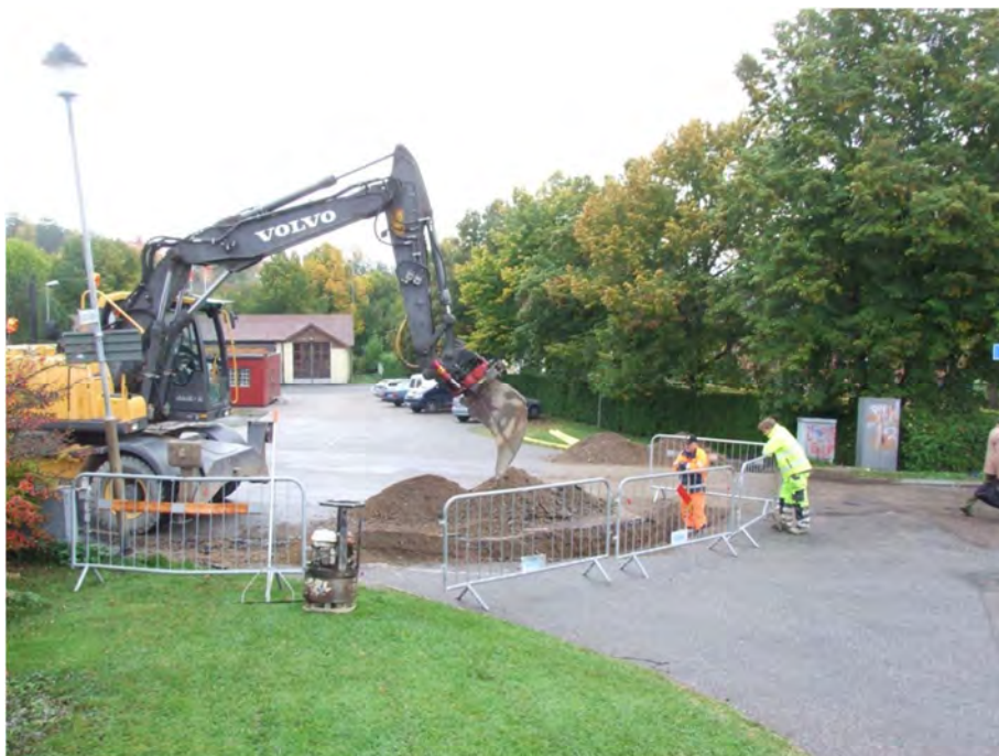
Figur 2. Schakt för el över Olofsgatan i Sigtuna, i norra delen av fornlämningsområdet för Sigtuna stadslager Raä 195:1. Schaktet löpte från ytan bakom elskåpen i bildens högra kant till elskåpet i bildens vänstra. Schaktet grävdes till övervägande del i recenta fyllnadsmassor. Foto Anna Ölund Upplandsmuseet.
