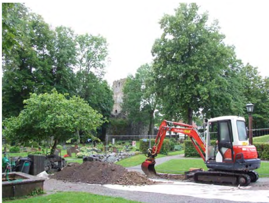
Figur 31. Schaktningen för etapp 3 påbörjas. Bakom jordhögen skymtar bogårdsmuren och i bakgrunden ses S:t Olofs kyrkoruin. Foto mot SV.
