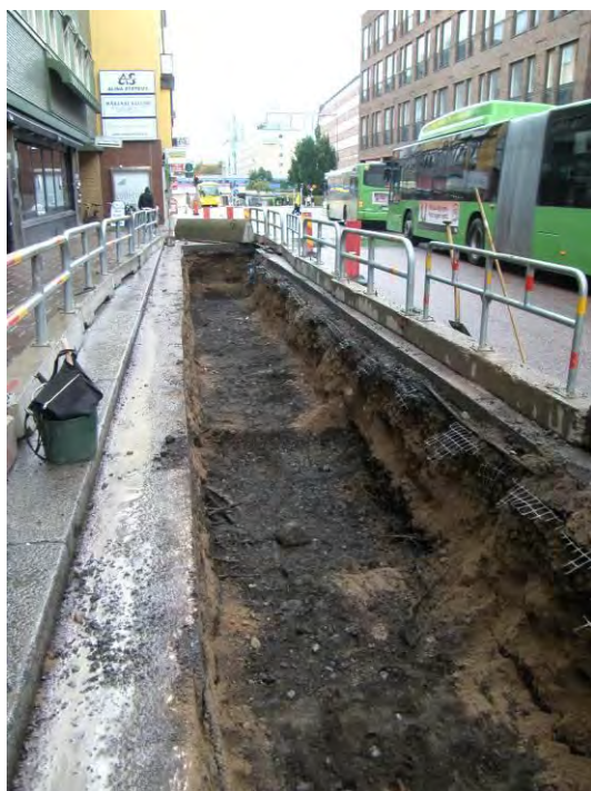
Figur 21. Längs stora delar av schaktet i Vaksalagatan, från 38 m och framåt, fanns risbäddar och grusbeläggningar. Detta har tolkats som lämningar efter den gränd som på regleringsgatan löper i ungefär samma läge som dagens Vaksalagata. I höjd med hinken på schaktkanten syns svetsgrop 10. Foto från sydväst, Linda Qviström/Upplandsmuseet.
