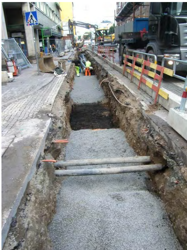
Figur 7. I ledningsschakten grävdes djupare gropar på de ställen där ledningarna skulle svetsas samman. På bilden från Vaksalagatan syns två av dessa, däremellan har grus lagts på som skyddsfyllning i botten av schaktet. Foto från sydväst, Linda Qviström/Upplandsmuseet.
