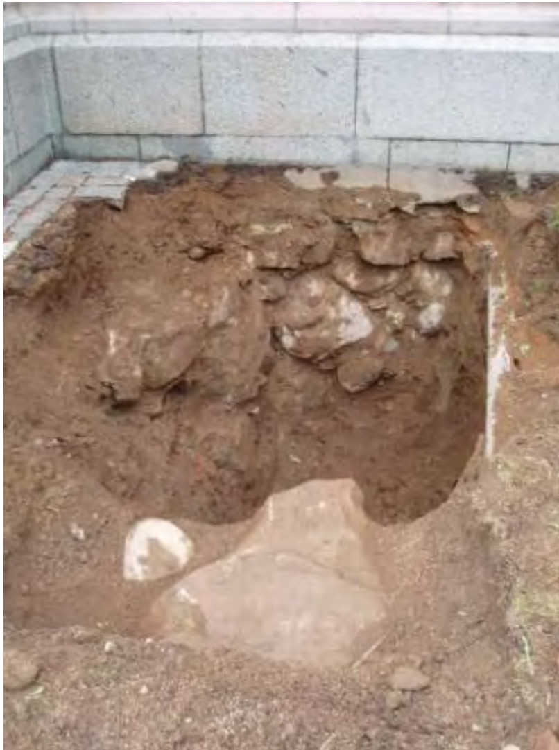
Figur 5. Schaktet mot kyrkan. I förgrunden två av stenarna som skall ha ingått i likbodens grundmur. Till höger i bild syns ett rör för elledning. Foto från norr.
