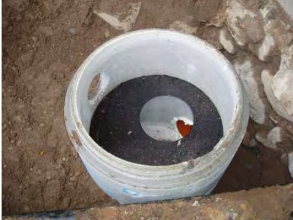
Figur 10. Cementröret där fläkten skall installeras är på plats. I botten skymtar röret som leder in mot vattenbrunnen.
