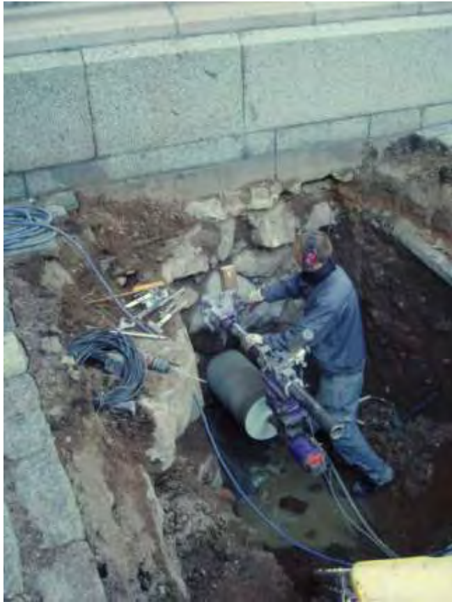
Figur 6. Borrning under arbete. Eftersom kyrkans grundmur inte kragade ut vid borrhålet, var det lätt att få plats med utrustningen och schaktet för radonbrunnen höll sig inom det gamla schaktet.
