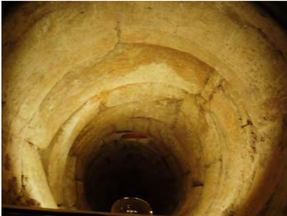
Figur 9. Foto ner i vattenbrunnen. Det inkommande borrhålet syns drygt två meter ner i brunnen. Det inre foderrör som sköts in i borrhålet syns tillfälligt. Detta har sedan dragit tillbaka och syns numera inte.
