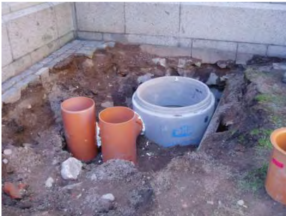
Figur 11. De två utblåsrören har kopplats in i den större cementbrunnen.
