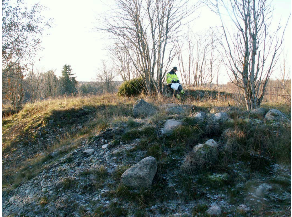
Figur 32. Stensättningen Vårfrukyrka 107:1 är på väg att ramla ut över rasbrant. Runt anläggningen finns ett flertal körspår. Foto Dan Fagerlund.
