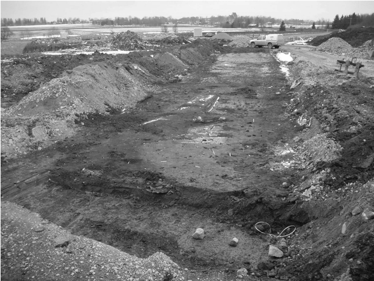
Figur 11. Schaktet under Vittulsbergsvägen. I bakgrunden skymtar Gamla Uppsala kyrka. Foto: Martin Scheutz.
