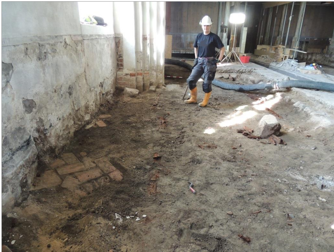
Figur 24. Elin Säll har precis rensat fram tegelgolvet i långhusets södra vägg. Foto mot V.
