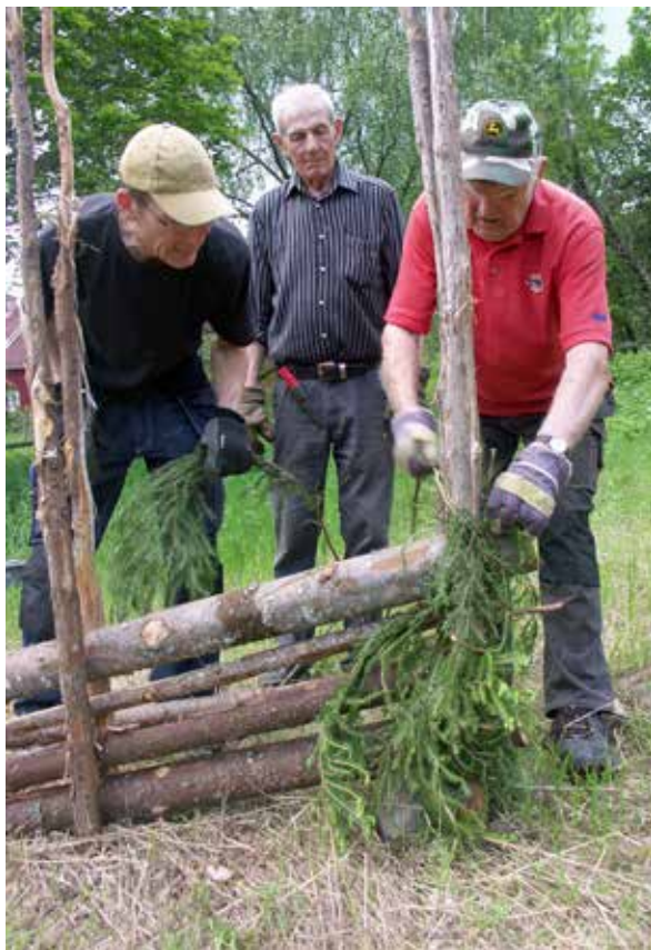
Gårdsgårdsbyggaren Ingvar Pettersson från Torstuna, demonstrerar för museets byggnadsvårdshantverkare Håkan Wallentinsson hur färska och basade kvistar av gran vrids till vidjor runt gårdsgårdsstörarna. Foto Agnetha Pettersson.
