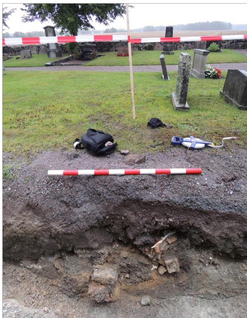
Figur 16: Tegelkonstruktionens läge i förhållande till gravarna. Den inrasade luftkanalen, som kan anas innanför teglet, försvinner in i den norra schaktkanten. Vy mot norr.
