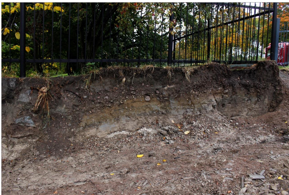
Figur 19. I den norra schaktväggen hade en sektion genom en av terrasserna grävts fram. Här syns tydligt att den anlagts genom att gräva ned i glacialleran för att sedan fylla upp med grus och sand. Foto mot N.
