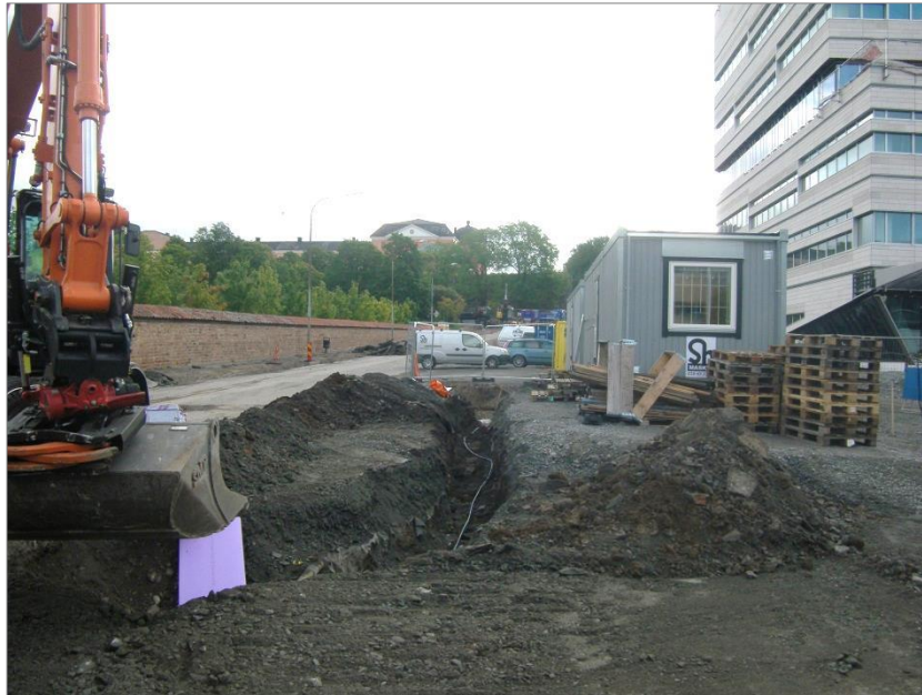
Figur 10. Schakt för anslutande vatten till byggbodarna grävdes i arbetsområdets västra del. Foto mot Ö. Anna Ölund, Upplandsmuseet.
