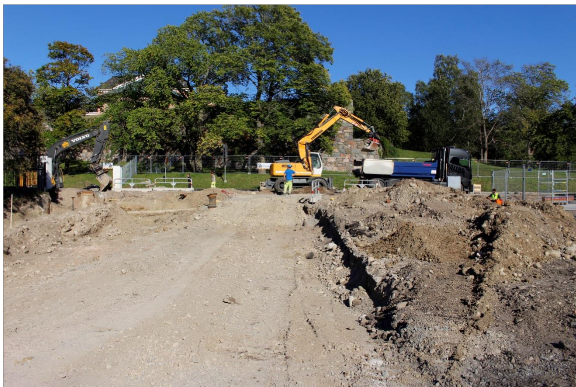
Figur 5. Pågående arbete i korsningen Dag Hammarskjölds väg – Norbyvägen. Under projektet arbetade ofta flera grävmaskiner samtidigt i olika delar av arbetsområdet. Foto mot Ö. Anna Ölund, Upplandsmuseet.
