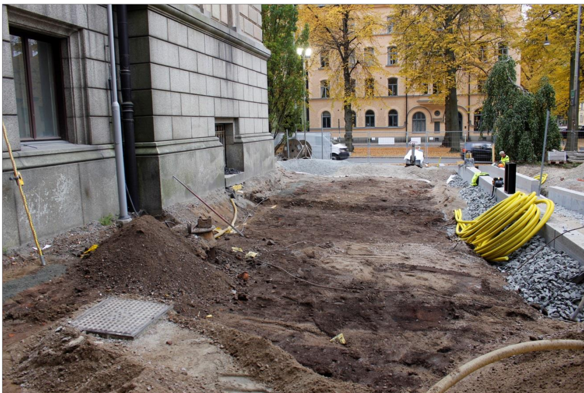
Figur 51. Schakt E grävdes på parkeringsytans sydöstra del intill Universitetshuset i syfte att sänka marknivån. Foto mot SV.
