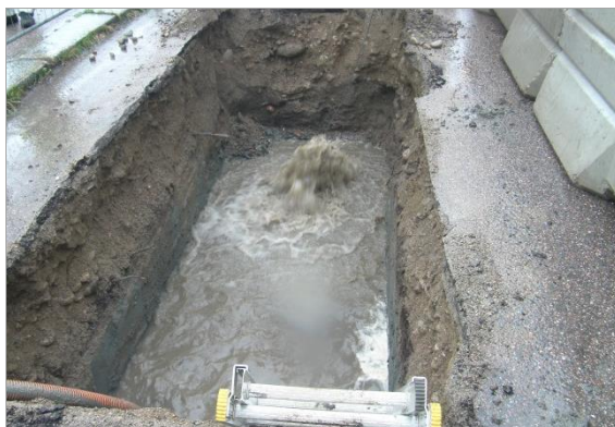
Figur 7. Vattenläcka i schakt 1. Foto: Malin Lucas, Upplandsmuseet.
