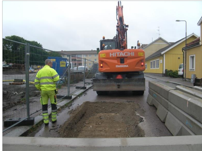
Figur 5. Påbörjad schaktning i Kryddgårdsgatan med kvarteret Fältskären i vänstra kanten. Foto Malin Lucas, Upplandsmuseet.
