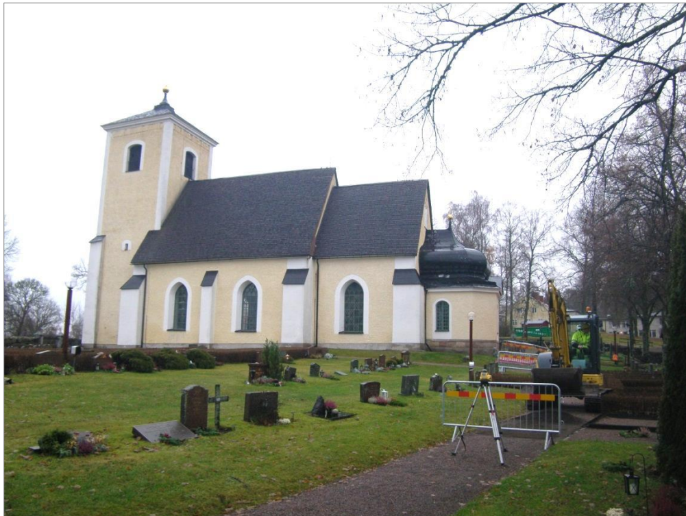
Figur 4. Pågående schaktningsarbeten vid Lena kyrka under december 2017 mot NNV. Foto Adam Hultberg, Upplandsmuseet.
