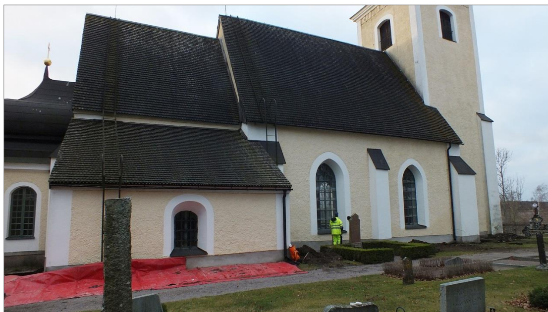
Figur 17. Schaktet längs Lena kyrkas norra sida grävdes i tjälad mark i december 2017. Foto mot SÖ, Elin Säll, Upplandsmuseet.
