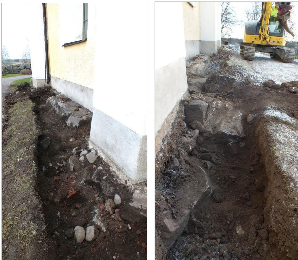
Figur 10, t.v. Lämningar efter vapenhus och trappfundament vid långhusets södra fasad. Närmast i bilden syns rester av östra muren och i bildens mitt, mellan strävpelarna, del av trappfundament mot långhusets yttervägg. Foto mot V, Elin Säll, Upplandsmuseet.
